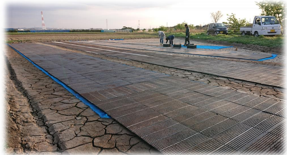
【置き床がひび割れて苗箱との接地面が密着していない様子】
